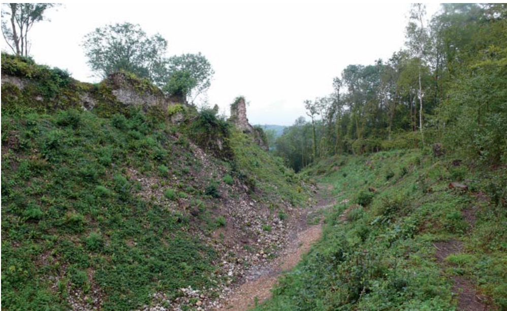
28. Vue des douves est. La profondeur est sensiblement diminuée par l'effondrement partiel de l'enceinte et de ses tours et par les remblais progressifs durant 8 siècles.
